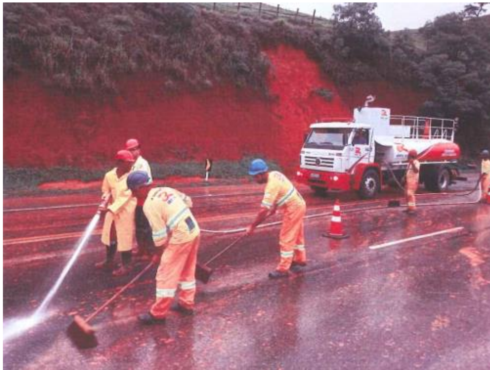
Figura 6.356.15 Rota 116 – Queda de Barreira – Km 119+600
