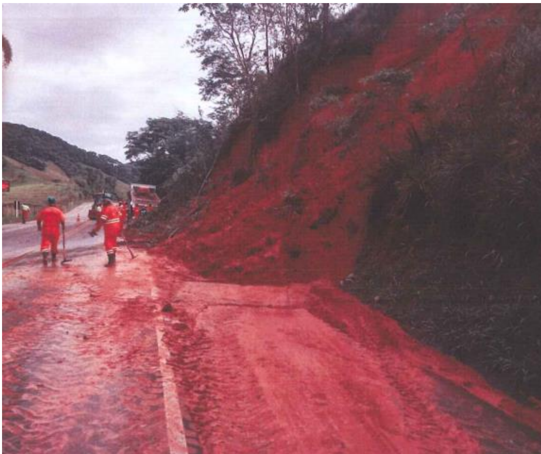
Figura 6.366.16 Rota 116 – Queda de Barreira – Km 127+000 Norte
