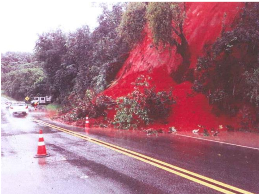
Figura 6.266.6 Rota 116 – Queda de Barreira – Km 34+700 Norte [2]
